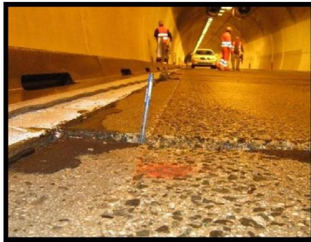
Slika 4. Vertikalni pomak između betonskih ploča
