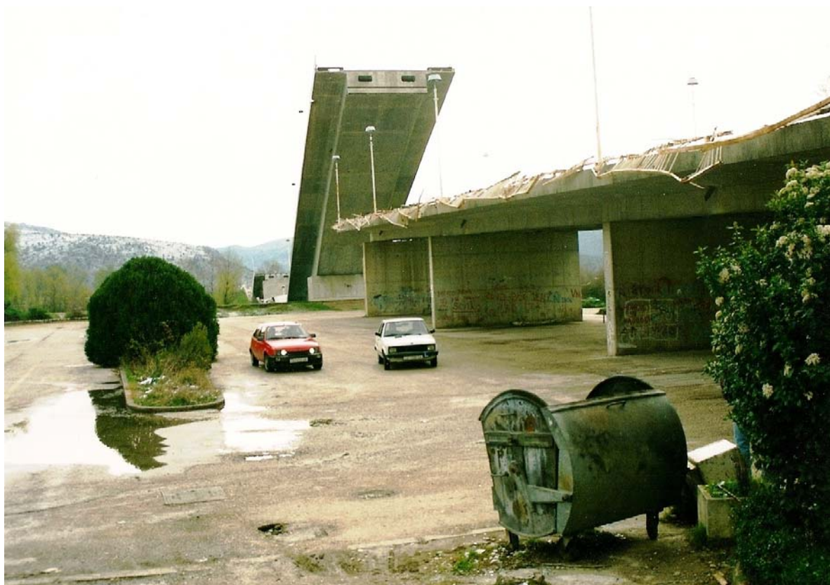
Slika 14. Pogled na porušeni most 1992. godine
